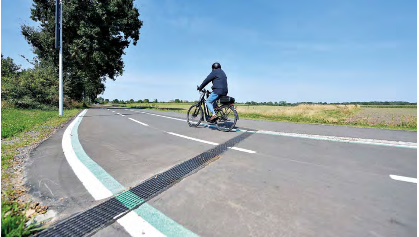
Entwässerungsrinne TOP auf der Premiumroute 1 in Achim
